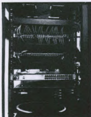
Figura 7: Rack principal - parte superior
