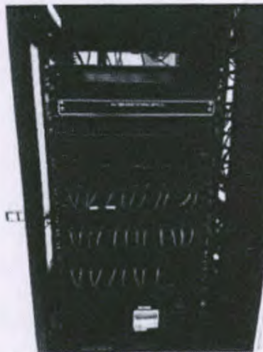
Figura 8: Rack principal - parte inferior
