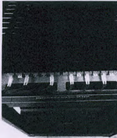
Figura 9: Distribuidor óptico do rack principal
