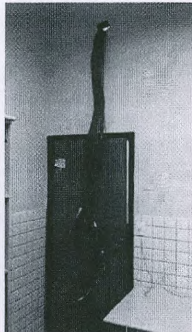
Figura 8 - Cabeamento do rack secundário
