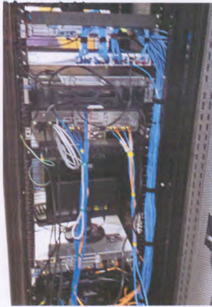
Figura 5 - Rack de servidores organizado
