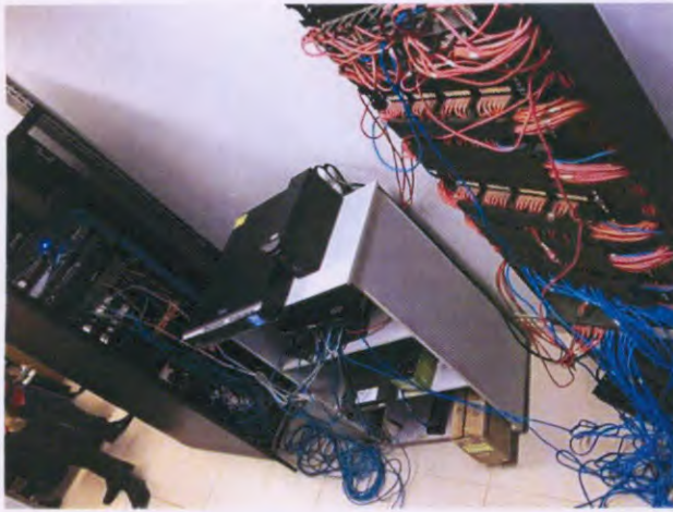
Figura 1 - Estrutura de racks no dia da chegada
