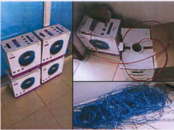
Figura 11 - Cabeamento utilizado (6 caixas 300m)
