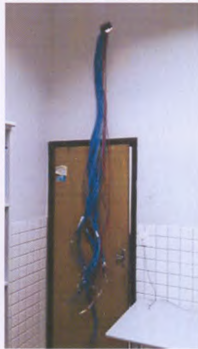
Figura 8 - Cabeamento do rack secundário
