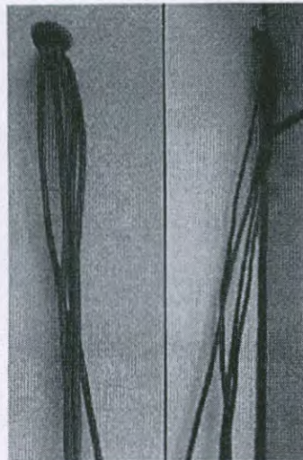
Figura 6 - Cabeamento inserido em gabinetes
